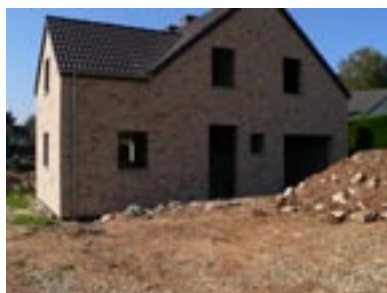
Toute nouvelle construction en zone d'assainissement autonome doit s'équiper d'un système d'assainissement.
